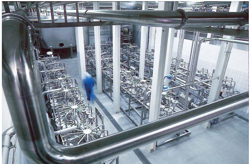
Udsnit af det nye raffineringsanlæg.
